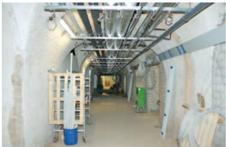
Abbildung 57. Große Schauaquarien erfordern eine umfangreiche Logistik, die im Untergeschoss des Westflügels untergebracht wurde. Zahlreiche Technikbecken aus Beton und ein kilometerlanges Leitungssystem für Süß- und Salzwasser sowie für die Heiz- und Kühlanlage sind im Oktober 2014 bereits realisiert.
